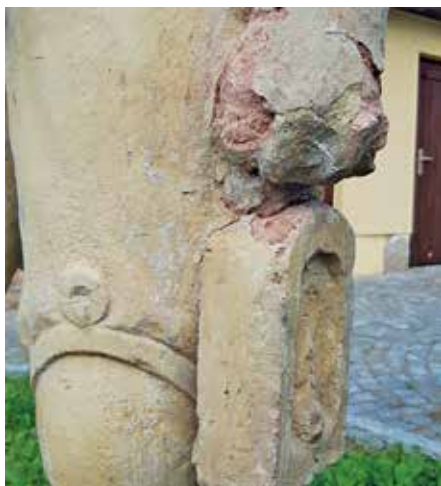
Sanierungsbedürftiger Zustand der Originalfigur.
