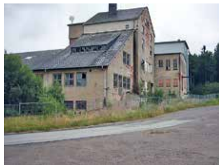
Die marode Gebäudesubstanz der Aufbereitung vor dem Abriss.
