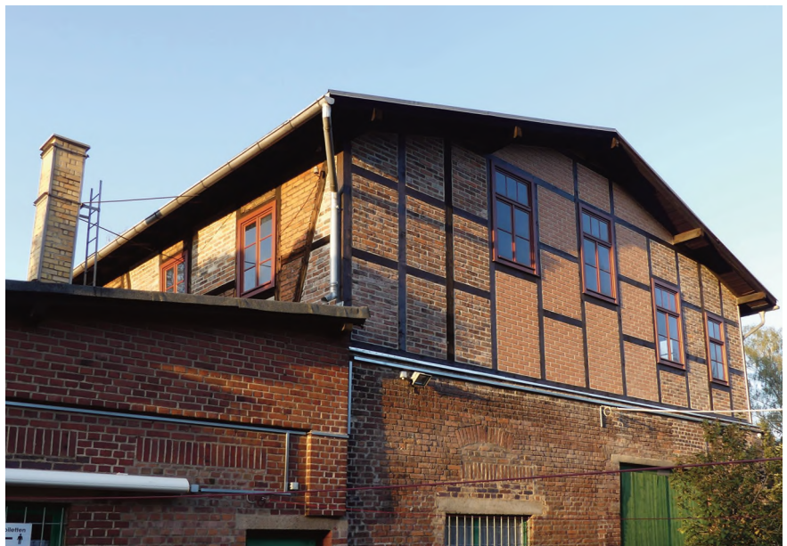
Der Südgiebel mit den sanierten Fenstern wurde ebenso neu aufgebaut (Fotos: Helmar Sittner)
