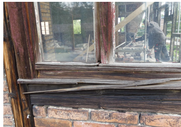
Typischer Zustand der Holzfenster vor der Aufarbeitung
